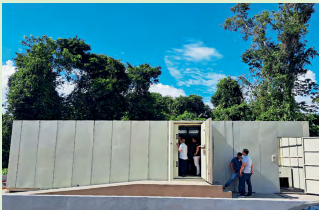
FIGURA 9: Data Center instalado no PCT Guamá (Fonte: SECEX)
